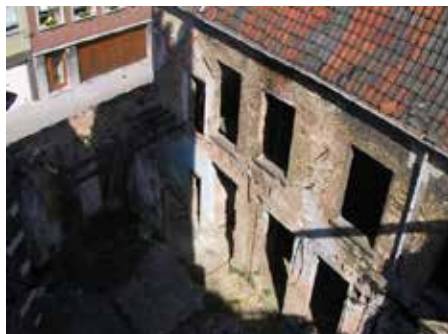
Deze foto geeft vanaf de huistoren een beeld van de verregaande verwaarlozing van de vroegere vleugel langs de Melaan omstreeks 2005.
