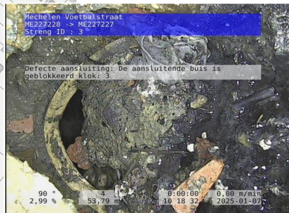
P_53459617_V219_2025-01-07_10201800.jpg, 00:34:01, 53.79m Defecte aansluiting: De aansluitende buis is geblokkeerd klok: 3
